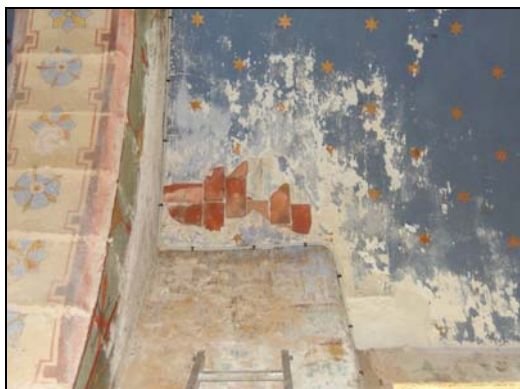
Photo de 2018 prise avant l'intervention des maçons.
